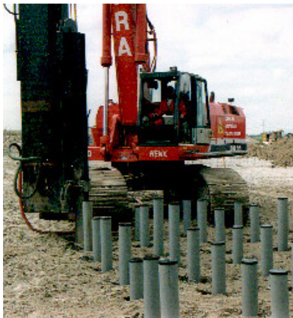
Installatie machine MZ-200
