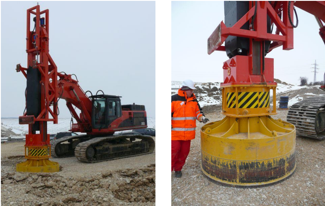
Obr. 6 Strojné vybavenie dynamického hutnenia
