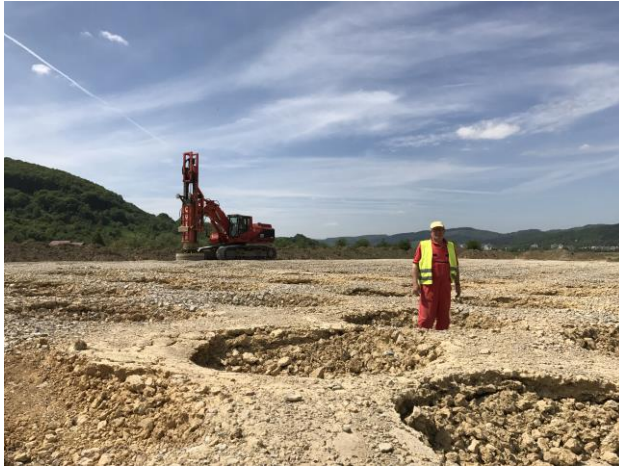
Obr. 3 Vzniknuté depresie po realizácii CDC
